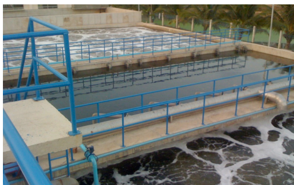
Gambar 8. Instalasi pengolahan air limbah sebagai indikator bangunan yang hijau dan sustainable Sumber: https://bizonawater.id/apa-itu-ipal-instalasi-pengolahan-air-limbah-apa-fungsi-ipal-tersebut/
