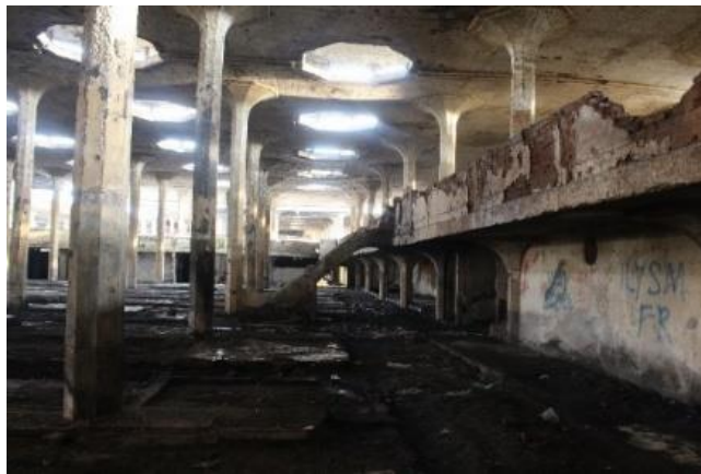
Gambar 10. Kondisi Pasar Johar Pasca Kebakaran
