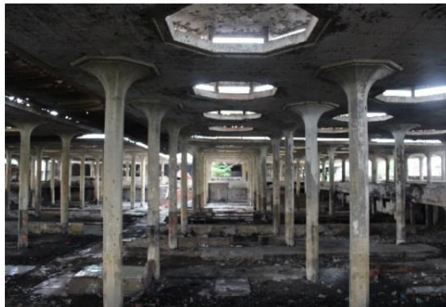
Gambar 1. Area di Dalam Pasar Johar Setelah Kebakaran
